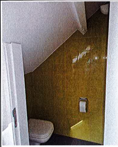
Foto 6: 226: er is onvoldoende verluchting mogelijk in de toiletfunctie
