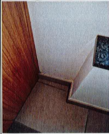
Foto 9: 112: VOCHTSCHADE: condenserend vocht met schimmelvorming
