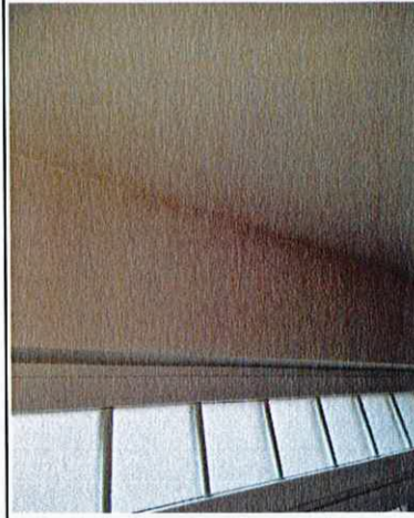
Foto 10: 112: VOCHTSCHADE: condenserend vocht met schimmelvorming
