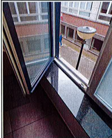
Foto 11: 233: ontbrekende of onvoldoende hoge/stevige borstwering bij lage ramen (vanaf eerste verdieping)
