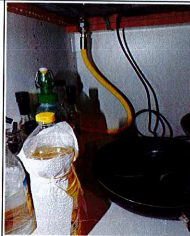
Foto 16: Conforme gasdarm keuken gelijkvloers
